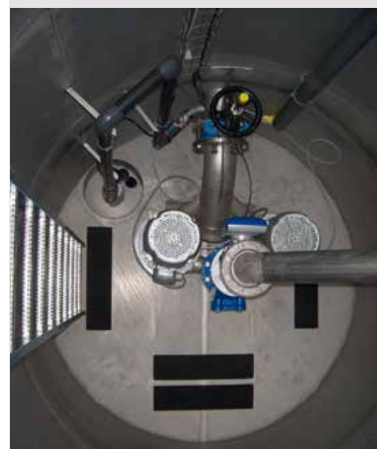
Izgled opremljenog prostora stanice
